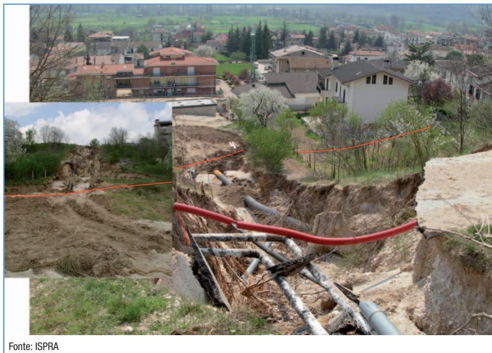
Figura 14.3: Voragine prodotta dalla rottura dell'acquedotto del Gran Sasso a seguito della riattivazione della faglia di Paganica, in occasione del terremoto del 6 aprile 2009
